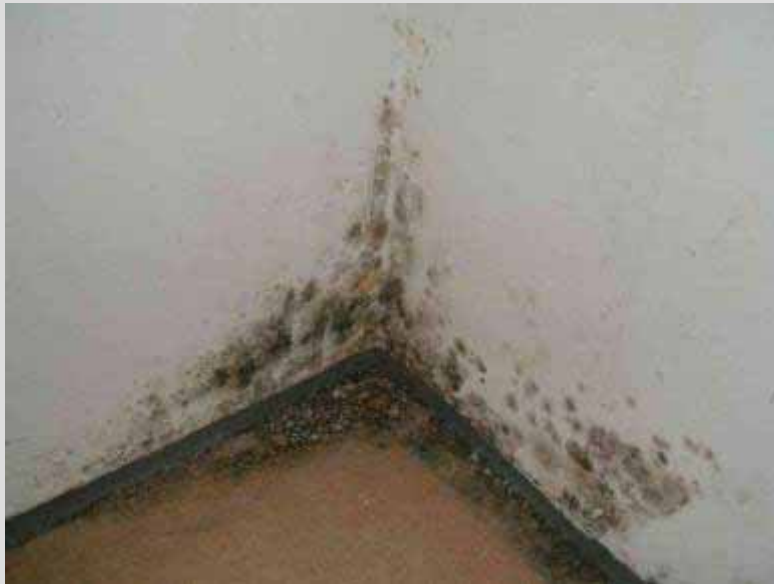
Schimmelbefall in unsanierter Raumecke durch deutliche Wärmebrücke
