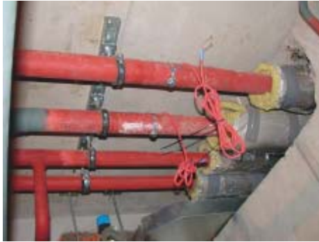
Abbildung 33: Kein Reduzieren oder sogar Aussetzen von Rohrdämmungen bei Wand- oder Deckendurchbrüchen
