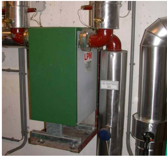
Abbildung 28: Mehrfach umgelenkte Plattenwärmetauscher erzielen die nötigen thermischen Längen
