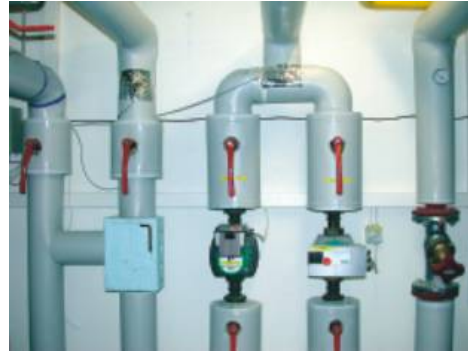
Abbildung 34: Armaturendämmung als wichtiges Puzzlestück in der Verlustminimierung
