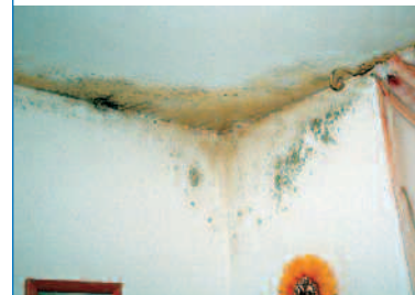
Bild 4: Schimmelpilzbefall undichtes Flachdach
