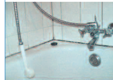
Bild 8: Beispiel für schwache Sporenexposition („Ohne besondere Gefährdung“) bei mit Schimmelpilzen befallenen Fugendichtungen
