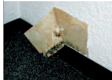
Bild 3: Schimmelpilzbefall unter der Tapete
