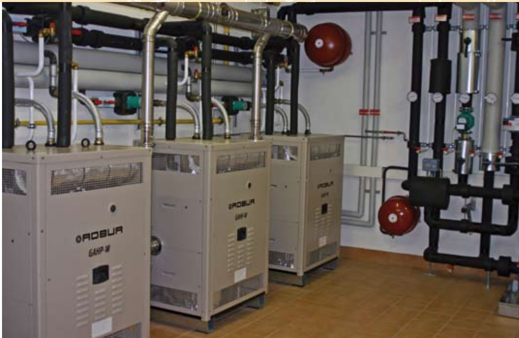
■ Bild 1: Die vierstufige Gas-Absorptionswärmepumpenanlage steht mit einem 170 m 3 großen, im Erdreich versenkten Latentwärmespeicher in Verbindung und bildet die Basis der Wärme- und Kälteerzeugung.
