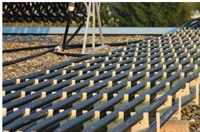
■ Bild 10: Mehrlagiger Flachdachabsorber.
