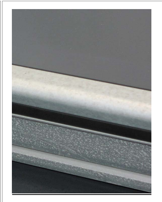
Bild 15: Ablagerungen auf Rahmenoberfläche
