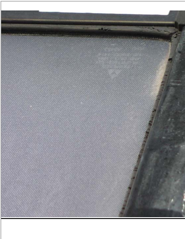
Bild 14: Risse / Versprödung der Dichtung
