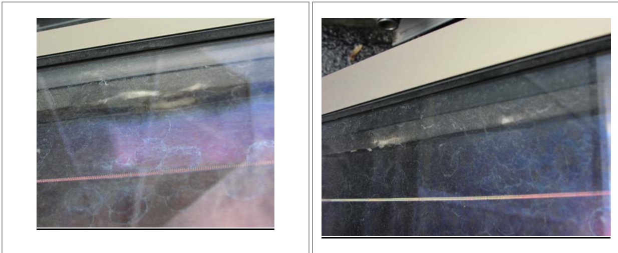
Bilder 8 und 9: Ablagerung von Schmutz auf der transparenten Abdeckung (Glasscheibe)
