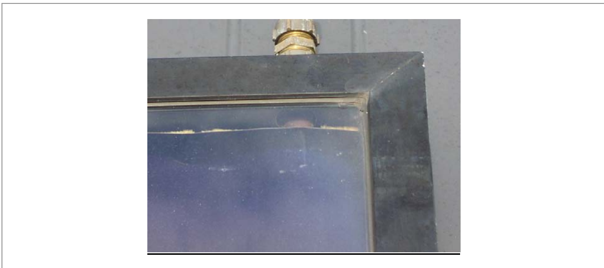
Bild 10: „Optische Alterungserscheinungen“ an Rahmen und Dichtung (insbesondere im Bereich der Ecke)
